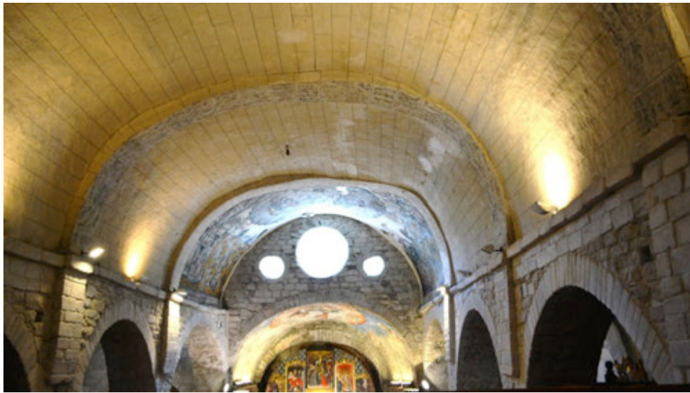
Figura 1. Estructura de obra de fábrica con grandes deformaciones Santa Maria d'Arties
